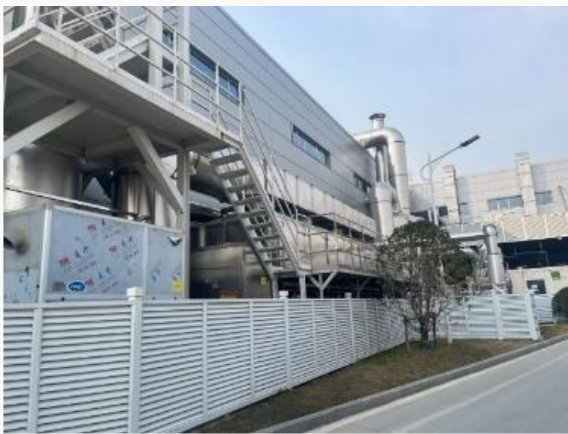
(废气处理装置)
